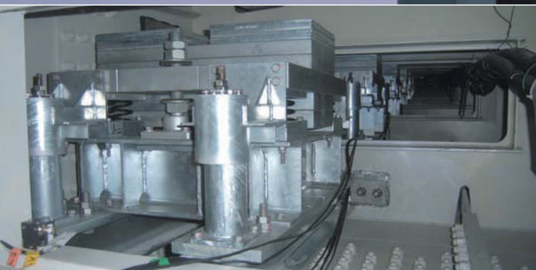
mD-500Vi (箱桁内設置用500kgタイプ)・・・箱桁内6基設置状況
