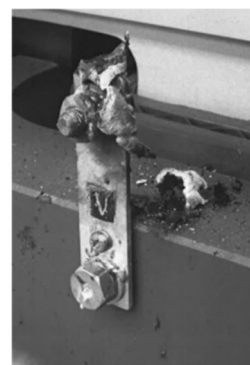
端子部が大揺れし端子部に過電流が流れて溶解 (2011年東日本大震災時)
